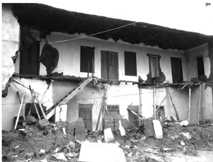
III. 76 : maison d'Almeida en grande partie détruite, 2009.
